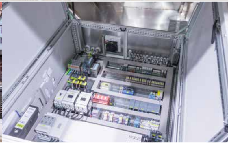
KONTROL KABİNİNİN İÇ GÖRÜNÜŞÜ
