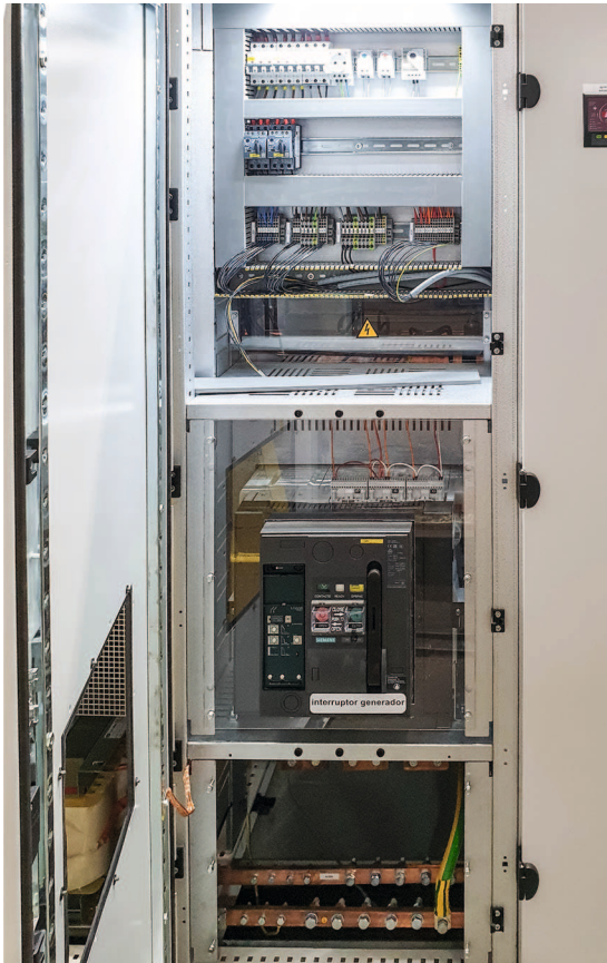
Orta voltaj elektrik panosu
