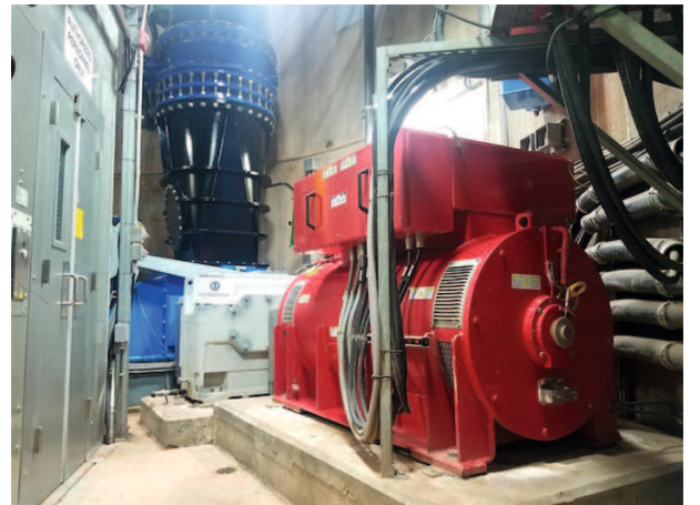
Kanada'da atık su boşaltım sisteminde türbin
