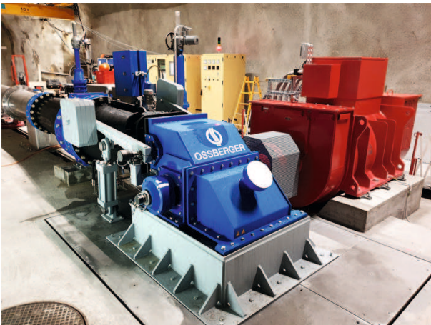
İsviçre'de kullanım suyu tesisi
